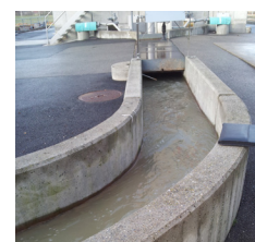
Открытый канал от песколовки до установки предварительного осветления
