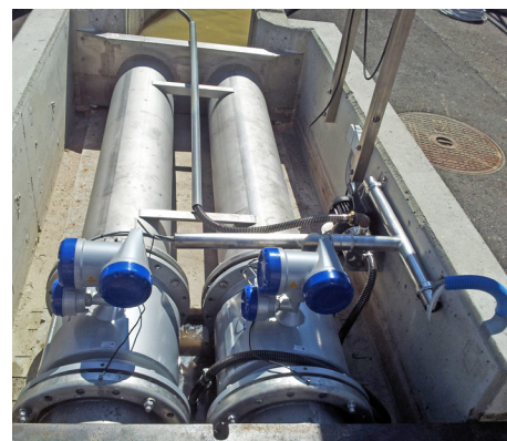
Установка TIDALFLUX 2300 в канализационном канале
