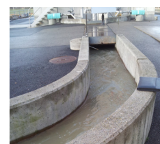
Offener Kanal vom Sandfang zur Vorklärung
