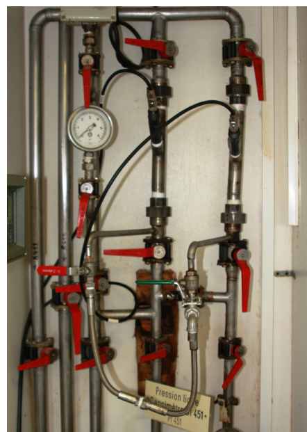
SMARTPAT PH 2390, установленный между гидрометром (слева) и дублирующим сенсором (справа)
