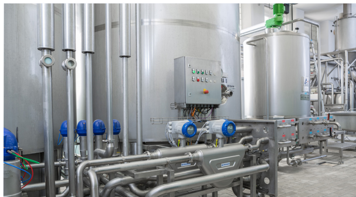
Установка OPTIMASS 6400 перед промежуточным резервуаром
