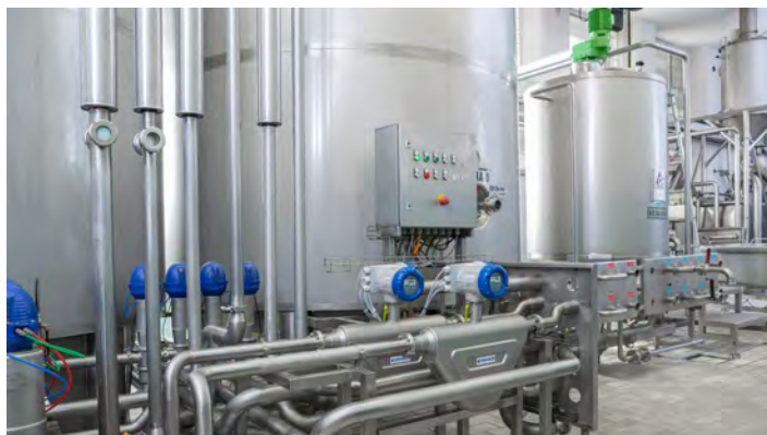
OPTIMASS 6400 devant le réservoir-tampon
