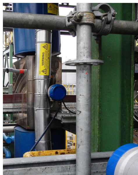
OPTIMASS 6400 F avec enveloppe isolante et raccordé à un système de traçage thermique
