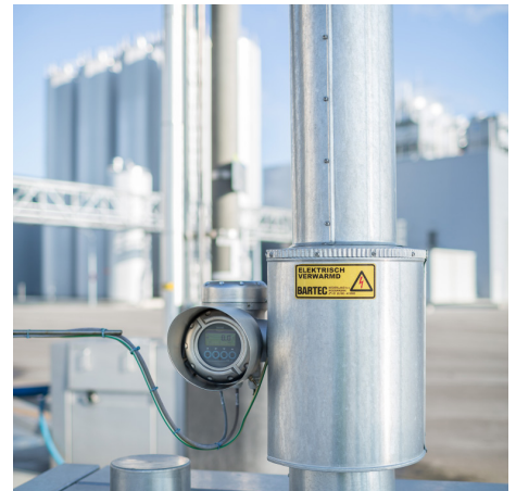
Durchflussmessung in der Rohmilchannahme mit dem OPTIFLUX 6300
