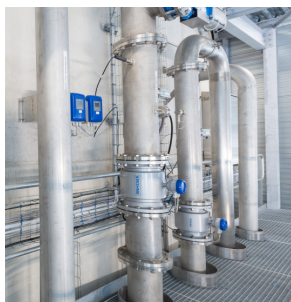
Durchflussmessung von Molkereiabwasser mit dem OPTIFLUX 2100 F
