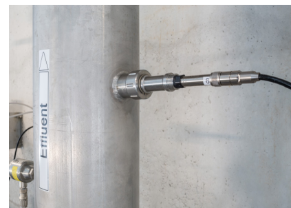
pH-Messung des Abwassers mit dem SMARTPAT pH 8150
