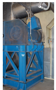
Blick in die Verdichter-Anlage
