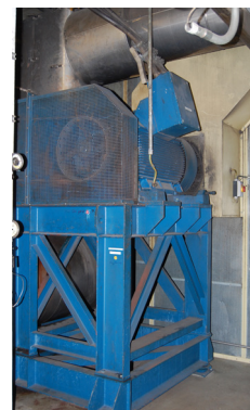
Вид компрессорной установки
