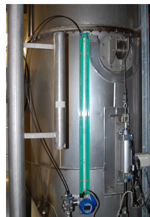
Mesure de pression différentielle dans la cuve à moût
