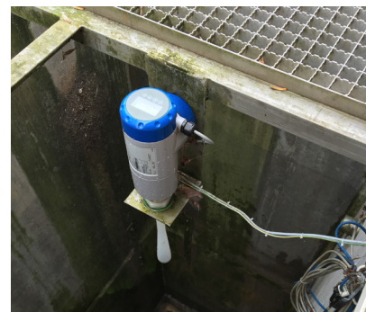
OPTIWAVE 5200 C über dem Abwasserbehälter
