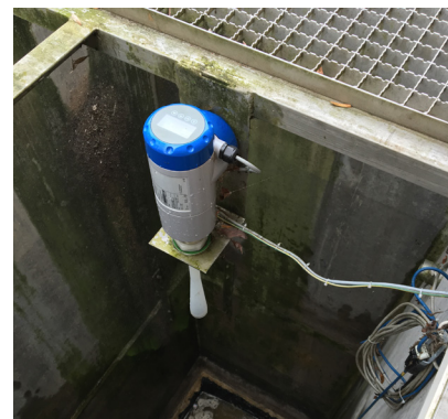
OPTIWAVE 5200 C над резервуаром для сточных вод
