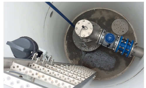
Oben links: Datenübertragung mit KGA 42; Oben rechts: OPTIBAR P 1010 C und WATERFLUX 3070 C; Unten: Blick in den Schacht
