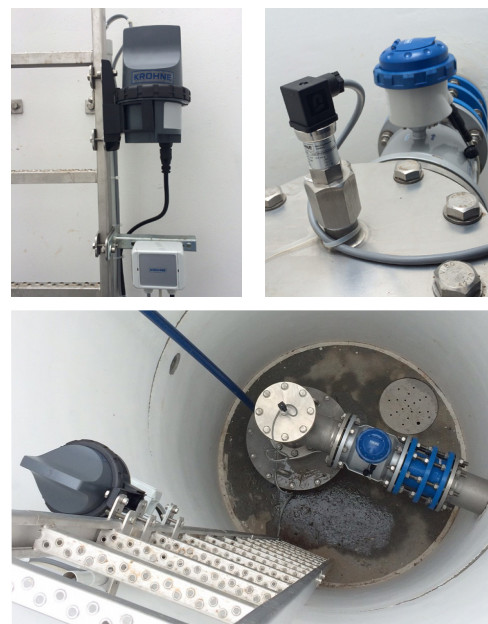
En haut à gauche : Transmission de données avec le KGA 42 ; En haut à droite : OPTIBAR P 1010 C et WATERFLUX 3070 C En bas : Vue dans le puits
