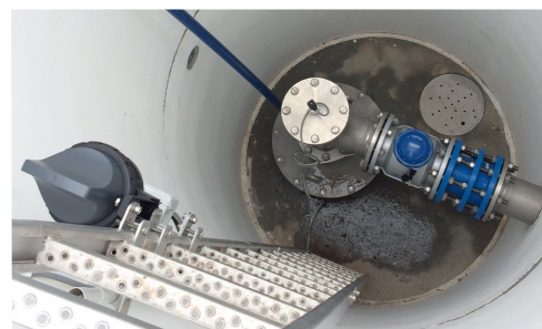
Вверху слева: Передача данных с помощью KGA 42; Вверху справа: OPTIBAR P 1010 C и WATERFLUX 3070 C Внизу: вид на ствол скважины
