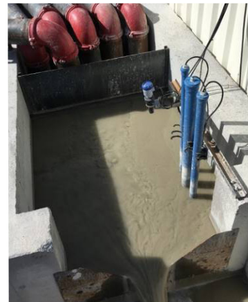
Messung von pH, Trübung, Leitfähigkeit und Füllstand
