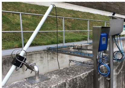
Измерение мутности в сточном канале
