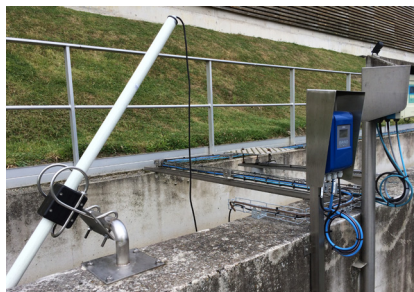
Mesure de turbidité en canal ouvert
