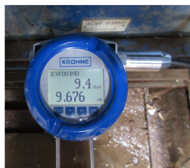
OPTIBAR DP 7060 C IP 68 sur eau du bassin de l'aéroréfrigérant
