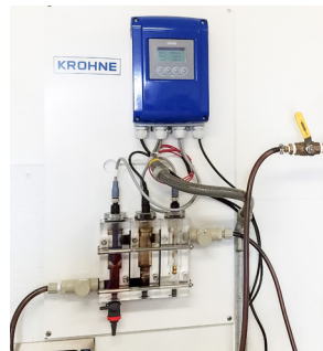
Installiertes OPTISYS CL 1100
