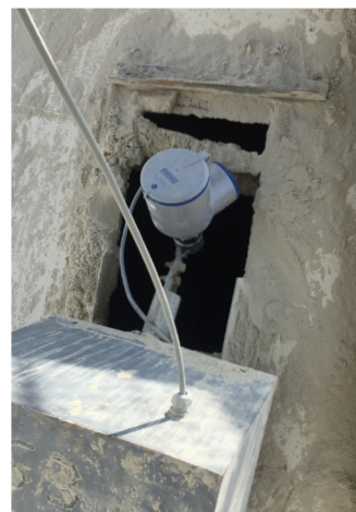
Переоснащение с применением устанавливаемого заподлицо радарного преобразователя уровня OPTIWAVE 6500
