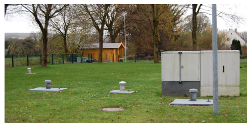
Передача измерительного сигнала в шкафы управления
