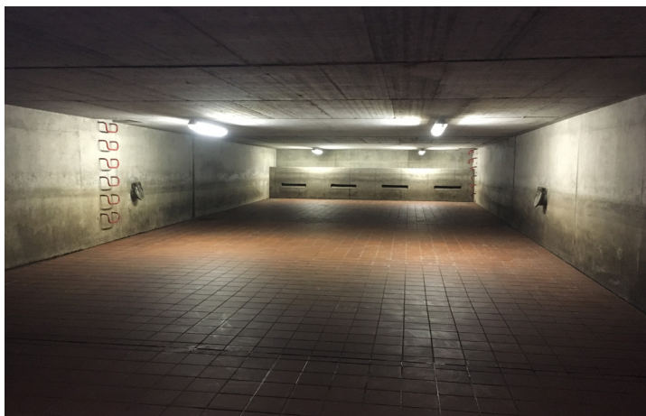
Подземный резервуар для ливневых вод в муниципалитете Шланген
