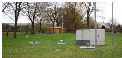
Вентиляционные шахты и шкафы управления над резервуаром для ливневой воды
