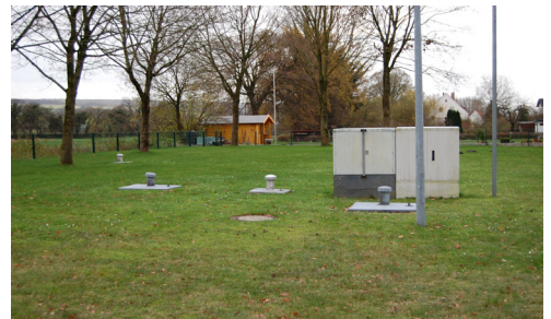
Entlüftungsschächte und Schaltschränke oberhalb des Regenbeckens
