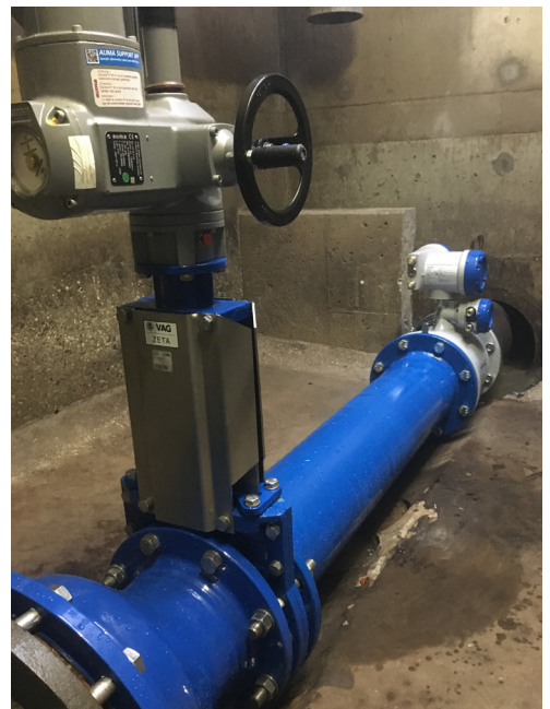
Messtechnische Lösung mit Durchflussmessgerät und Schieber
