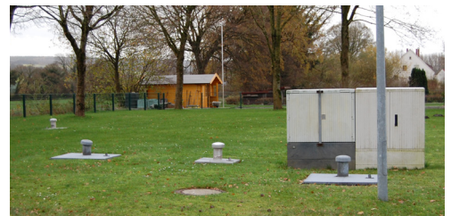
Übergabe des Messsignals an die Schaltschränke
