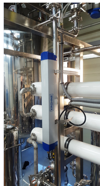
Débitmètre à montage externe mesurant l'eau pour préparation injectable (PPI)
