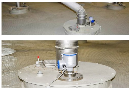
Installation à proximité du col de remplissage
