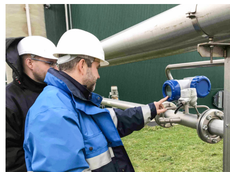
Mise en service de l'appareil par un technicien KROHNE
