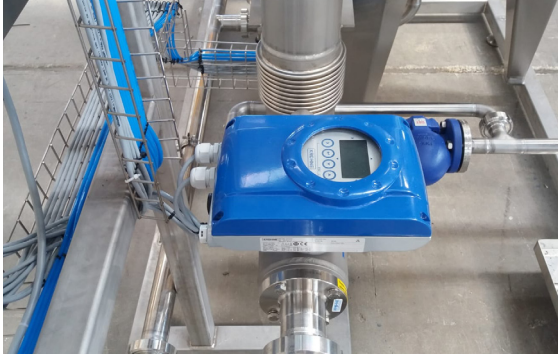
CIP skid ünitesinde OPTIFLUX 6050 C
