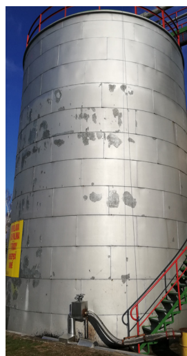
Sběrná nádrž provozní vody
