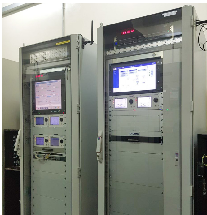
Шкафы управления контрольных систем, оснащенные вычислителями расхода SUMMIT 8800 и программным обеспечением SynEnergy
