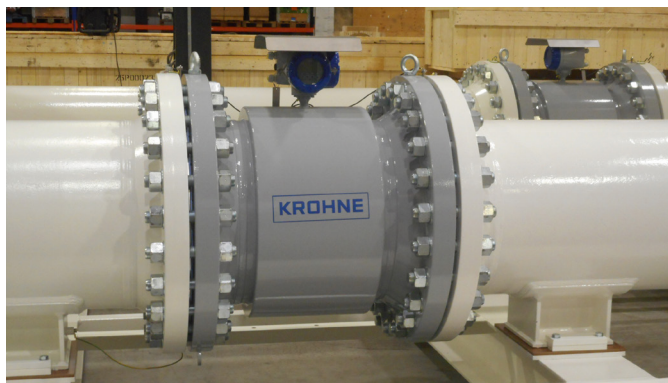
OPTIFLUX 2300, установленный в водомерном узле
