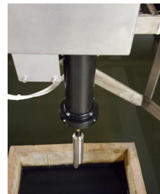
Sensor und Spüleinheit des Schlammspiegel-Messsystems
