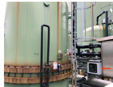
Klimatisierter Schaltschrank mit KROHNE Trübungsmesssystem (siehe Pfeil)
