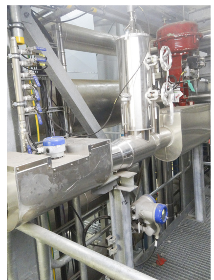
Speisewassermessung mit dem Ultraschall-Durchflussmessgerät OPTISONIC 3400
