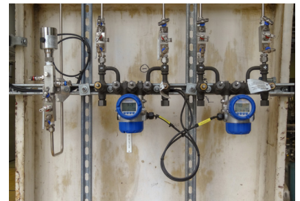
Differenzdruck-Durchflussmessung mit dem OPTIBAR DP 7060 und Überdruckmessung mit dem OPTIBAR PM 3050 (links im Bild)
