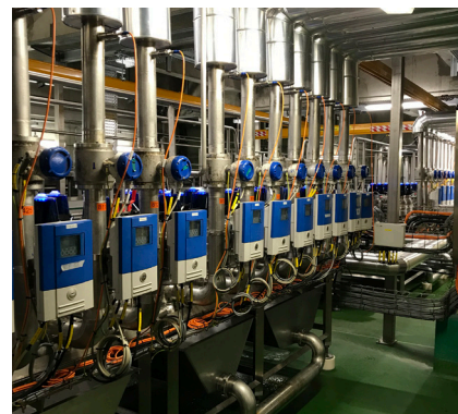
Mesure du débit de bière avec les OPTIFLUX 6300 installés sur les tanks de bière filtrée
