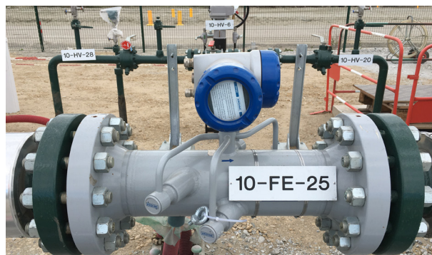
Débitmètre à ultrasons OPTISONIC 7300 avant sa mise en service
