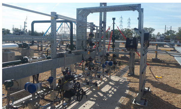
Débitmètres Coriolis KROHNE installés sur le démonstrateur P2G
