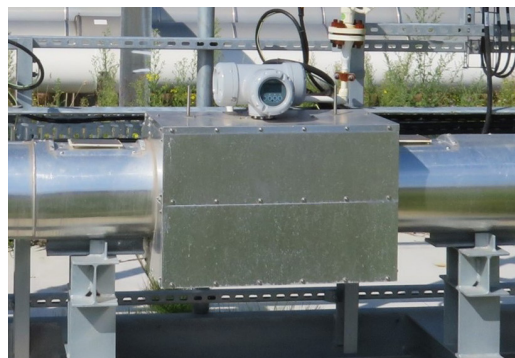
MID-zertifizierte, eichpflichtige Ultraschall-Durchflussmessung von Wasserstoff-Methan-Gemisch
