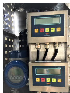
Převodník signálu Coriolisova průtokoměru KROHNE (vlevo)
