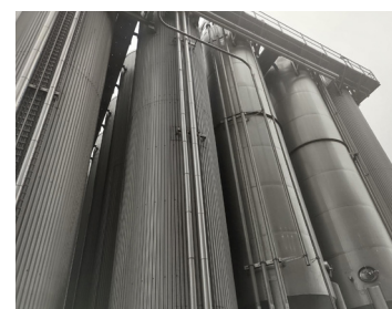
Vorrattanks mit KROHNE Drucktransmittern
