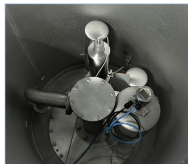
Installation des primären Drucktransmitters oben im Tankstutzen
