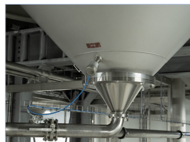
Installation des sekundären Drucktransmitters am konischen Tankboden
