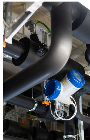
Magnetisch-induktive Durchflussmessung von Warmwasser
