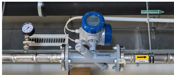
Durchflussmessung von Erdgas für den Luftbefeuchter
