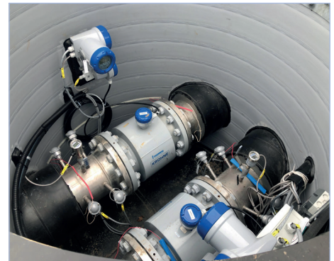
Fernwärme-Anwendung mit Durchflussmessgerät OPTISONIC 3400 District Heating, Temperaturfühlern und Drucktransmitter OPTIBAR PM 3050
