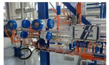
Abgesetzte Messumformer von OPTISONIC 3400 District Heating neben Energierechner
