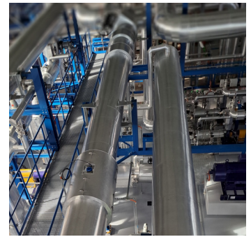
Isolierte Fernwärmeleitung mit Strömungsgleichrichter und Ultraschall-Durchflussmessgerät
