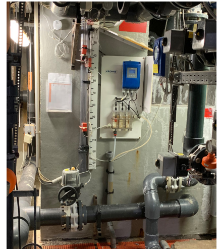
Bypass-Messung zur Überwachung von freiem Chlor in einem Thermalbecken
