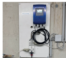
Wasseranalysepanel mit OPTISENS PH 8300 und integrierter Temperaturmessung
