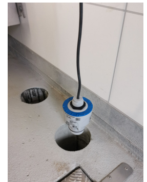
Installation von OPTIWAVE 1520 Radar-Füllstandmessgerät
