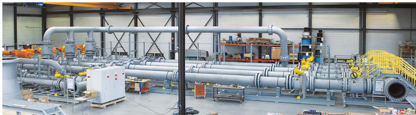
Een meetstelsel voor aardgas, drie meters fungeren als duty meters en kunnen via de cross-over geverifieerd worden tegen de (4 e ) master meter
