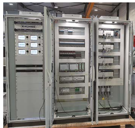
Metering Control Cabinet in KROHNE's werkplaats in Dordrecht
