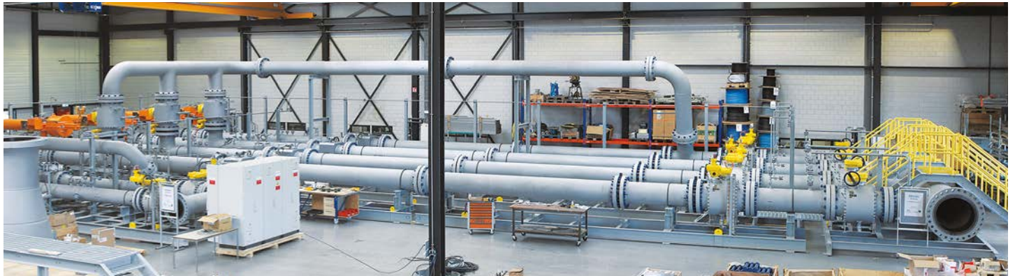
Een meetstelsel voor aardgas, drie meters fungeren als duty meters en kunnen via de cross-over geverifieerd worden tegen de (4 e ) master meter
