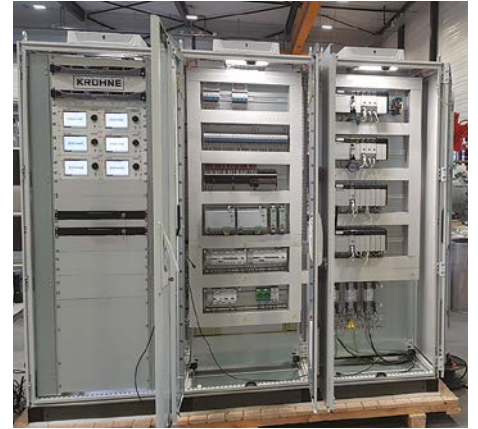
Metering Control Cabinet in KROHNE's werkplaats in Dordrecht
